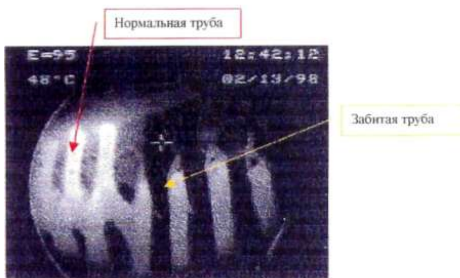
Рис.3.1 Термограмма труб поверхностей нагрева котла
